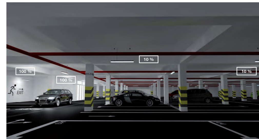
Wenn in einem Bereich eine Bewegung wahrgenommen wird, schalten sich die Leuchten an. Und wenn keine Bewegung mehr wahrgenommen wird, werden sie nach einer Zeitverzögerung auf das Sicherheitslevel gedimmt.
