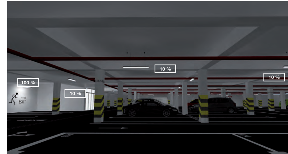
Wenn die Sensoren keine Bewegung wahrnehmen, scheinen die Leuchten bei einem Sicherheitslevel von 10 %, außer an den Garagen-Ausgängen, wo aus Sicherheitsgründen ein höheres Beleuchtungsniveau erforderlich ist.
